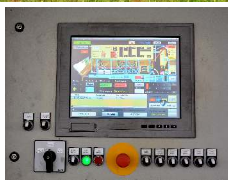
Řídicí systém s přehlednou dotykovou obrazovkou s propojením na tablet s dispečerským programem
